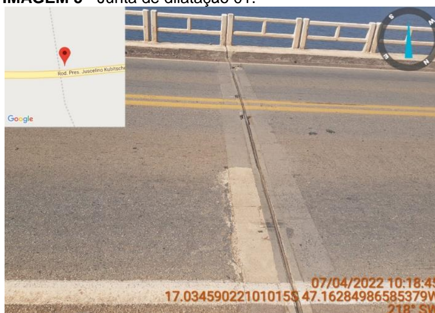
IMAGEM 5 - Junta de dilatação 01.
