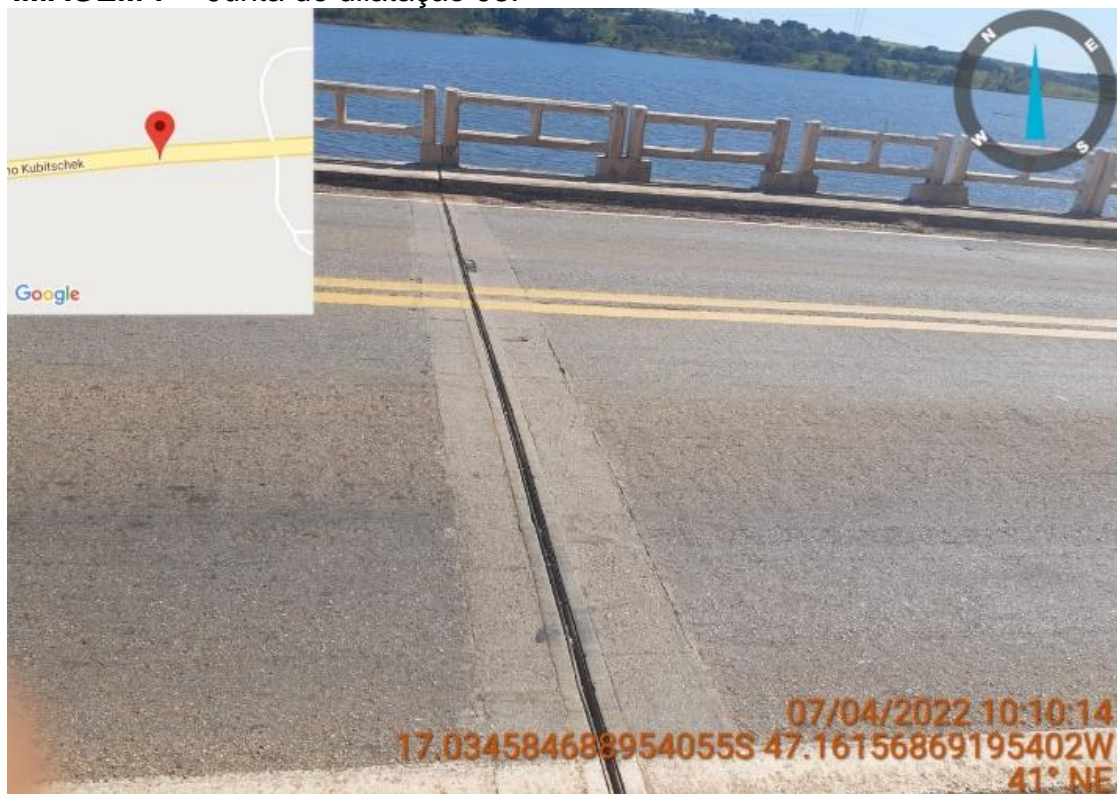
IMAGEM 7 – Junta de dilatação 03.
