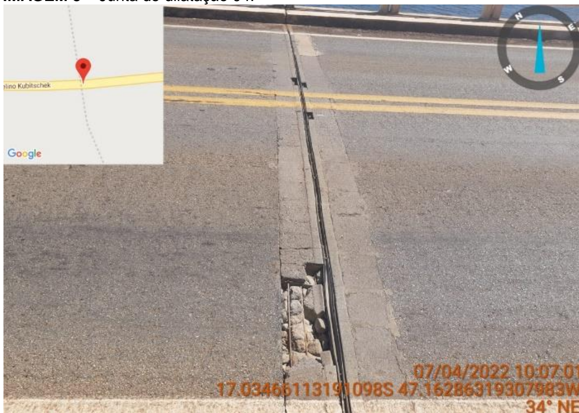
IMAGEM 8 – Junta de dilatação 04.
