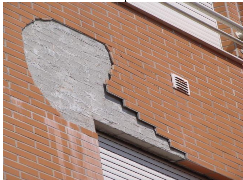
FIGURA 4: Destacamento de placa cerâmica em fachada
