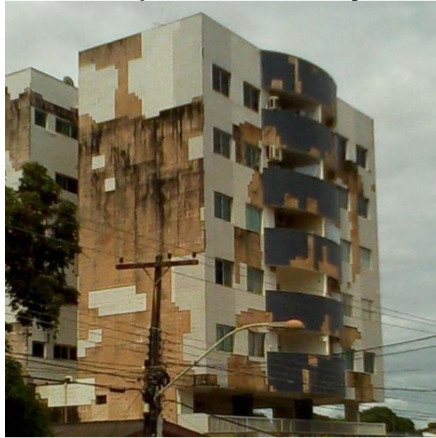
FIGURA 2: Infiltração e descolamento em parede externa
