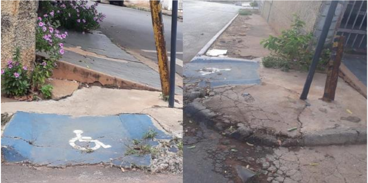
Figura 2 – Condição precária da rampa de acesso do local de estudo.
