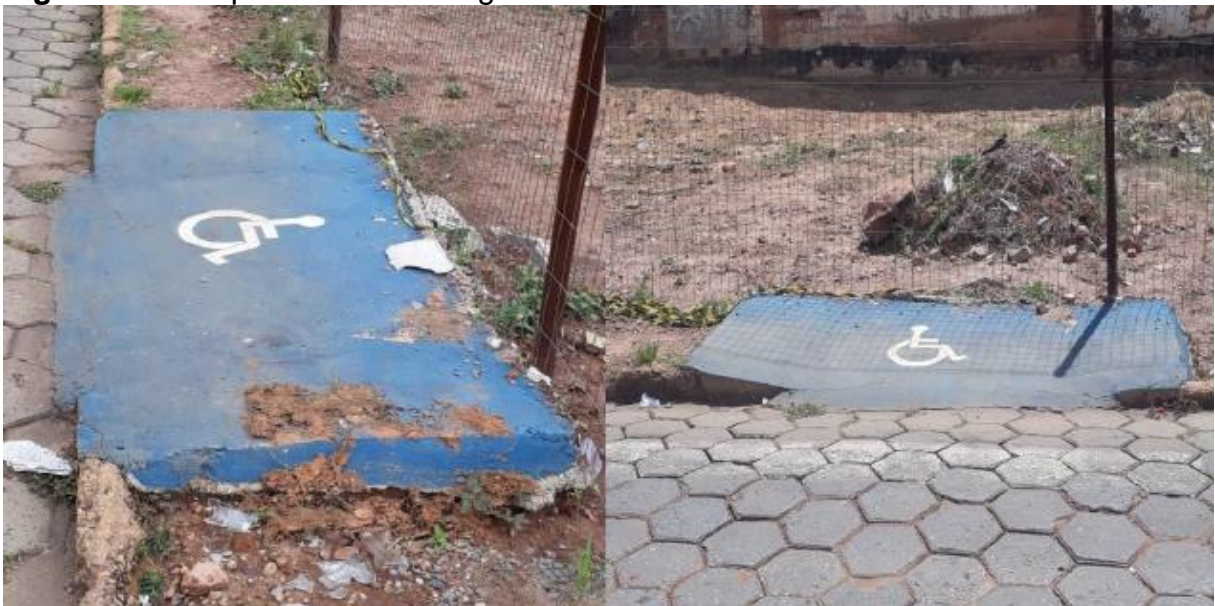
Figura 1 – Rampa de acesso irregular.
