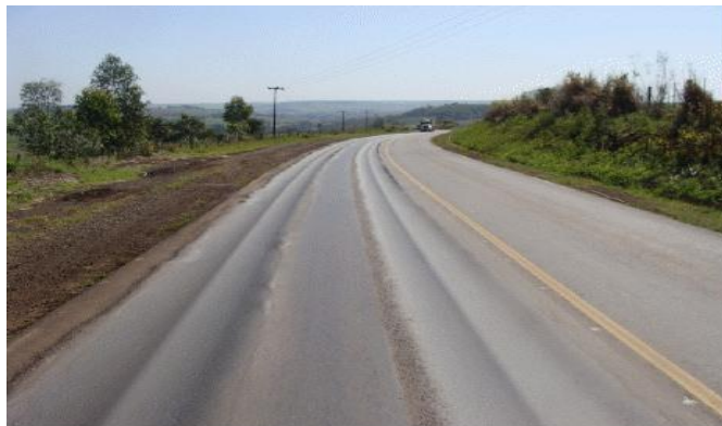
Figura 8: Afundamentos em pavimentos asfálticos
