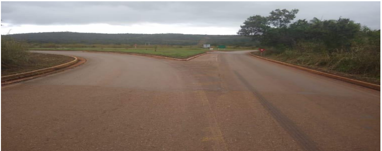
Figura 4 – Falha na sinalização horizontal onde quase não se é possível identificar a sinalização ali implantada, nota-se também a falta de sinalização de advertência vertical na via.
