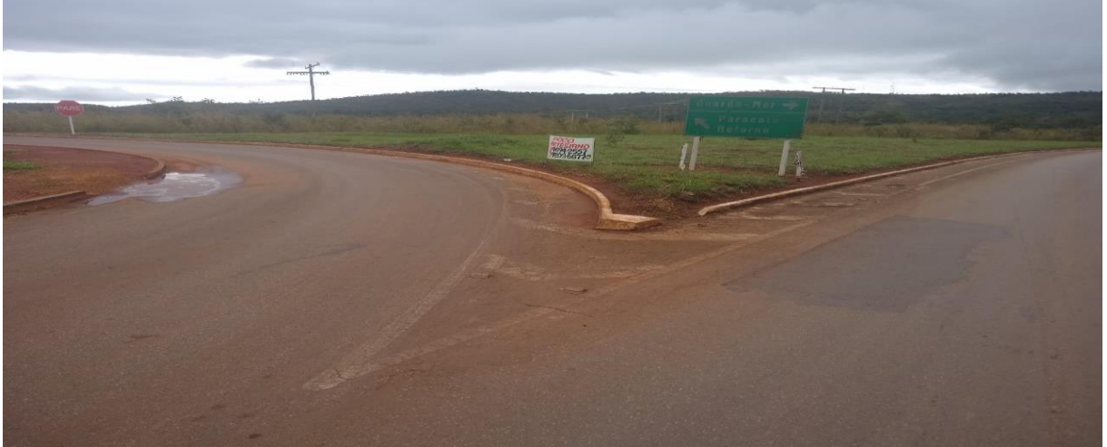
Figura 3 – Ligamento do trevo com faixas obstruídas e placas de indicação apagadas.
