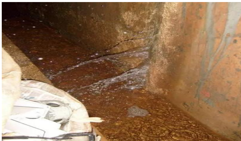
Figura 10 - Patologia do percolamento de água (PINHEIRO, 2019).
