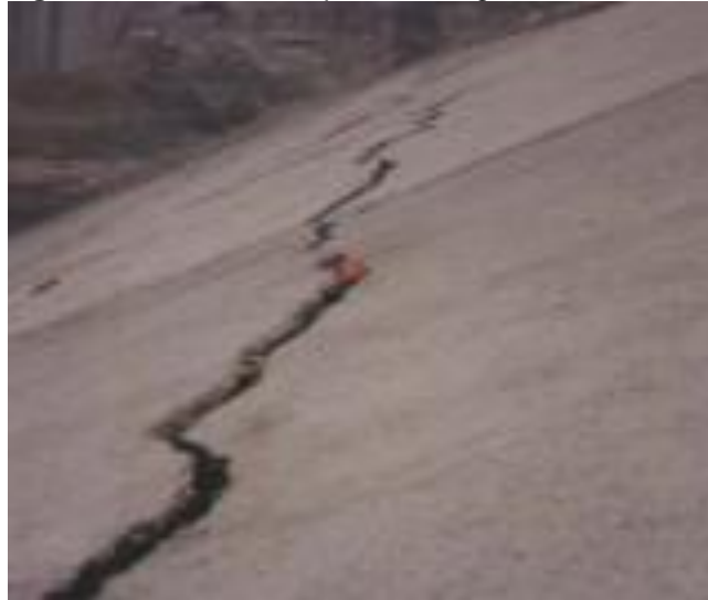
Figura 3- Trincas no corpo da barragem.
