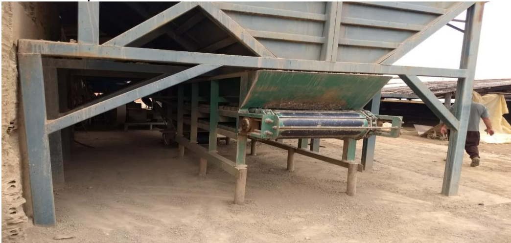
FIGURA 11- Caixão que alimenta as esteiras
