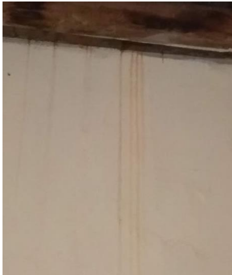
Figura 4 – Manchas na parede
