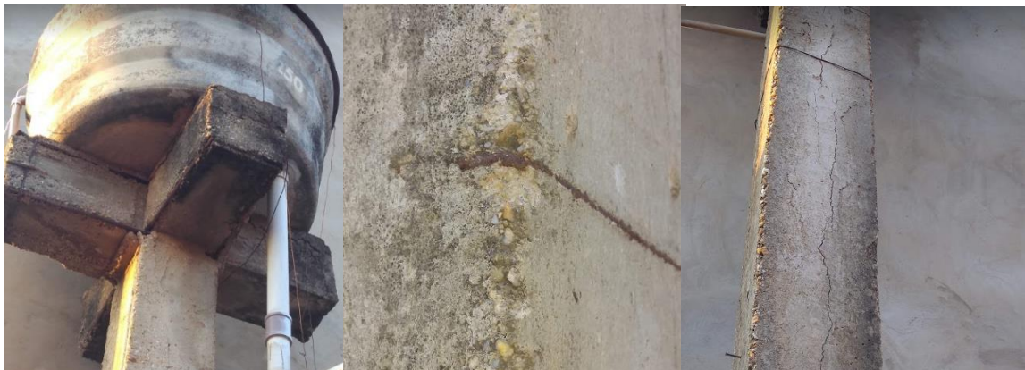
Figura 6 – Detalhes do pilar da caixa d'água
