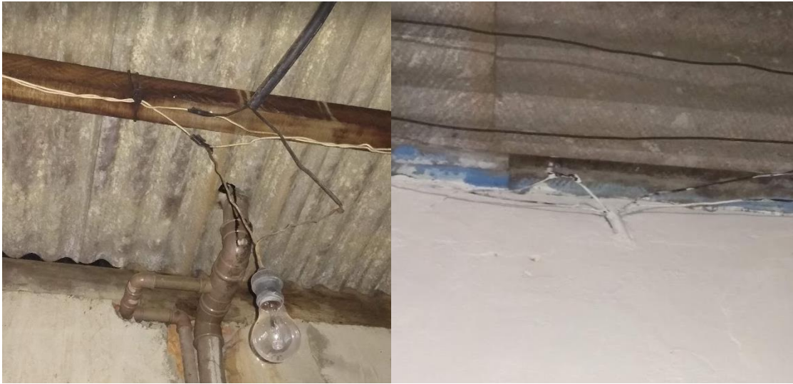
Figura 3 – Detalhes da fiação
