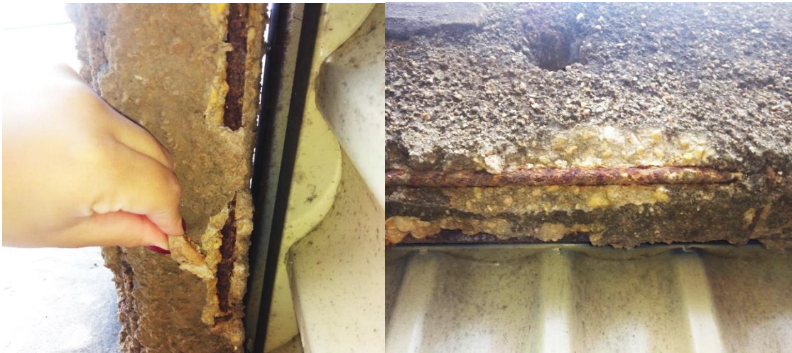
Figura 8 – Detalhe do destacamento
