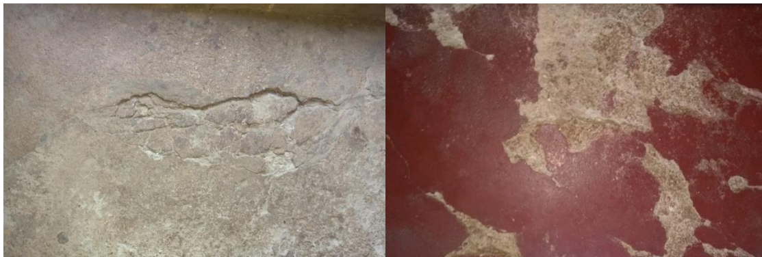
Figura 2 – Situação do piso
