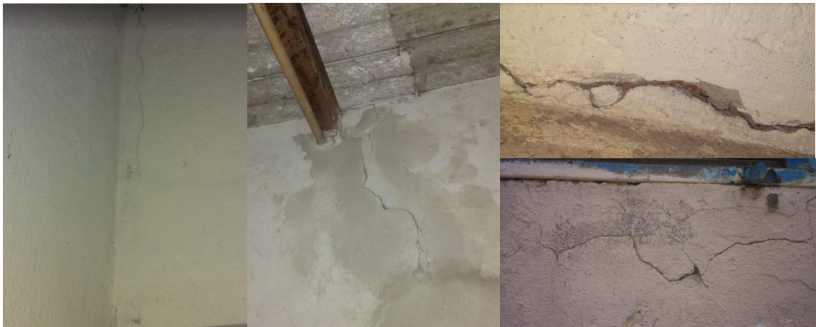
Figura 1 – Fissuras, trincas e rachaduras
