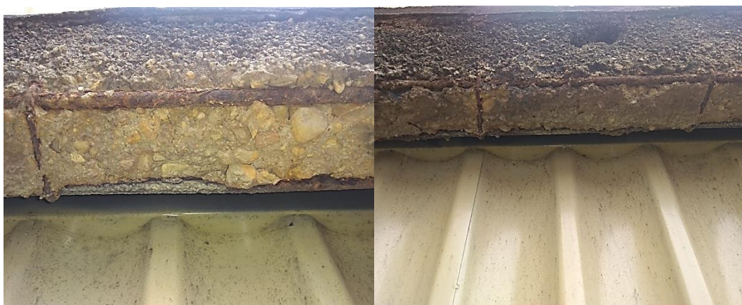
Figura 7 – Detalhe do estágio de degradação
