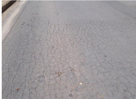
Figura 20 - Trincamento tipo couro de jacaré.
