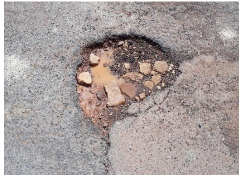
Figura 19 - Panela com presença de água.
