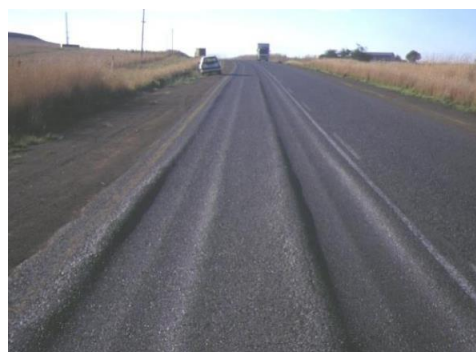
Figura 18 - Afundamento de Trilha de roda.
