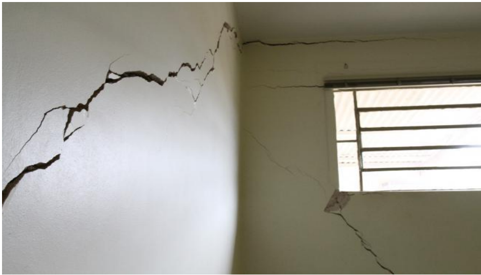
FIGURA 2 – Fissura em estágio avançado.
