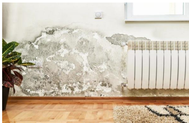
FIGURA 1 – Infiltração na parede.
