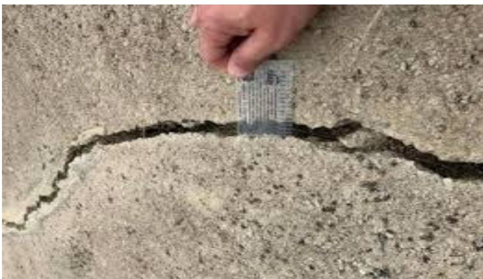
FIGURA 3 - Abertura no concreto devido a material ruim.
