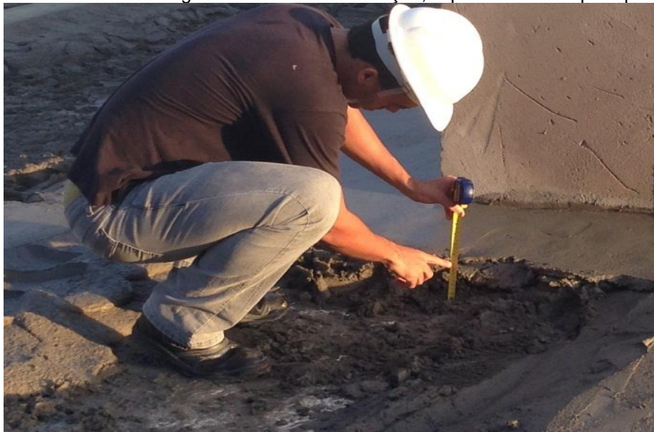
FIGURA 1: Perda segundo a unidade de medição, espessura maior que a prevista no piso.
