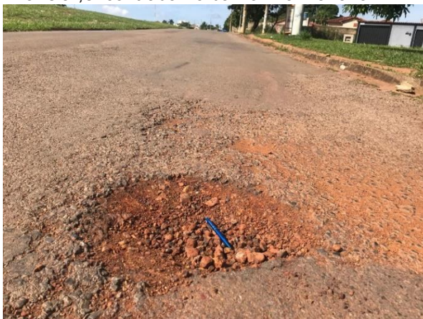
FIGURA 12 – Patologia do tipo “Desgaste” e do tipo “Panela”, encontrada no bairro Vila Mariana.
