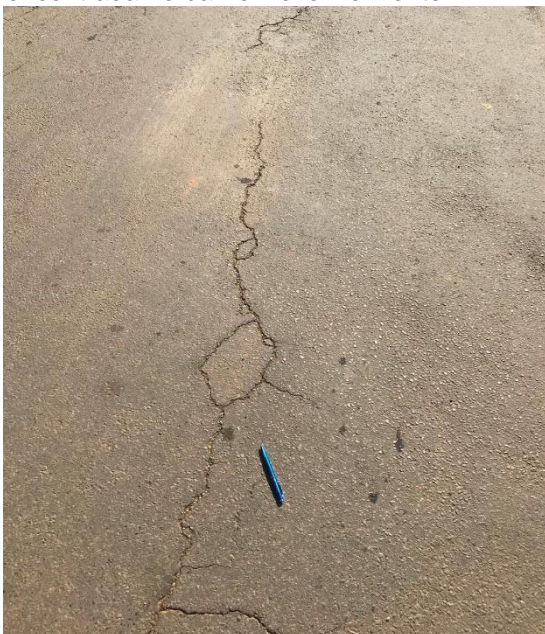
FIGURA 10 – Patologia do tipo “Trinca longitudinal”, encontrada no bairro Novo Horizonte.
