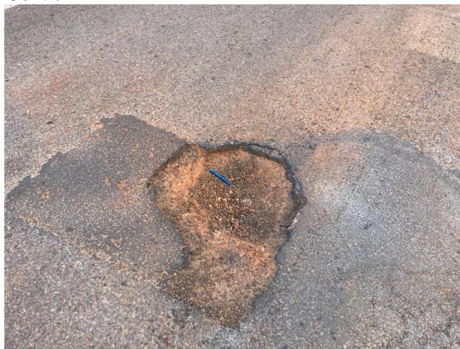
FIGURA 6 – Patologia do tipo “Panela”, encontrada no bairro Centro.
