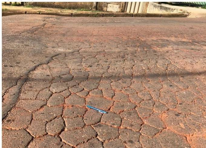
FIGURA 2 – Patologia tipo “Couro de Jacaré”, bairro Novo Horizonte.
