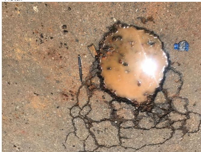
FIGURA 5 – Patologia do tipo “Panela”, encontrado no bairro Bela Vista.
