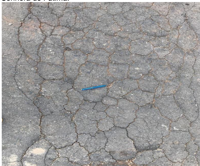
FIGURA 3 – Patologia tipo “Couro de Jacaré”, bairro Nossa Senhora de Fátima.
