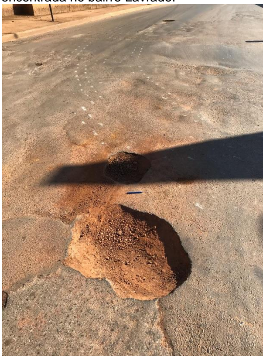
FIGURA 8 – Patologia do tipo “Panela”, encontrada no bairro Lavrado.
