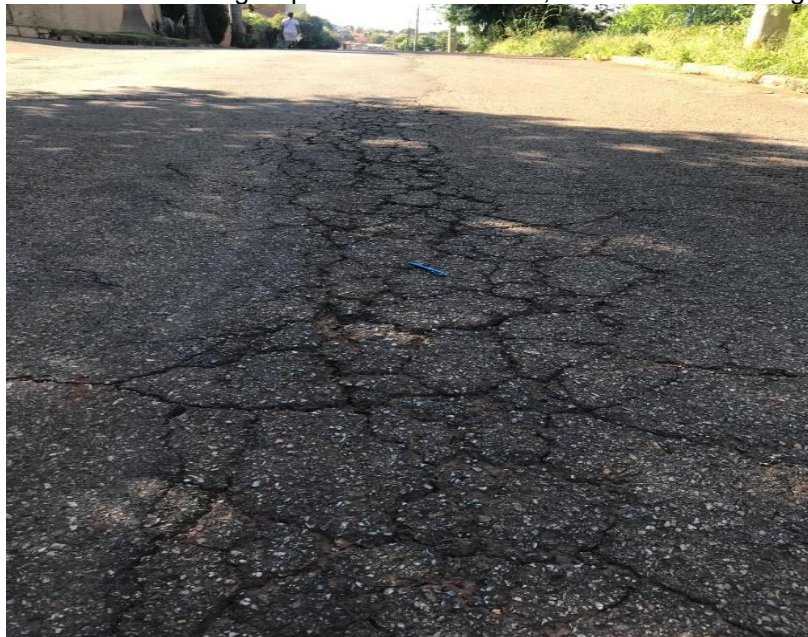
FIGURA 1 – Patologia tipo “Couro de Jacaré”, bairro Alto do Córrego.
