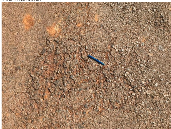
FIGURA 13 – Patologia do tipo “Desgaste”, encontrada no bairro Vila Mariana.
