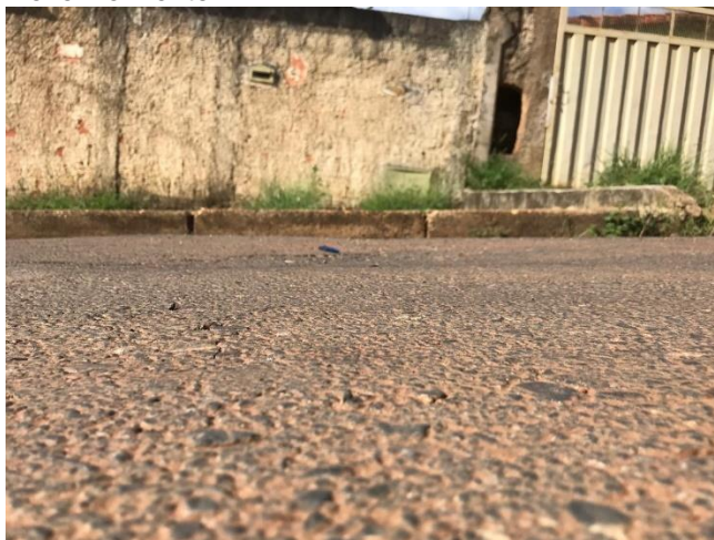
FIGURA 11 – Patologia do tipo “Desgaste”, encontrada no bairro Novo Horizonte.
