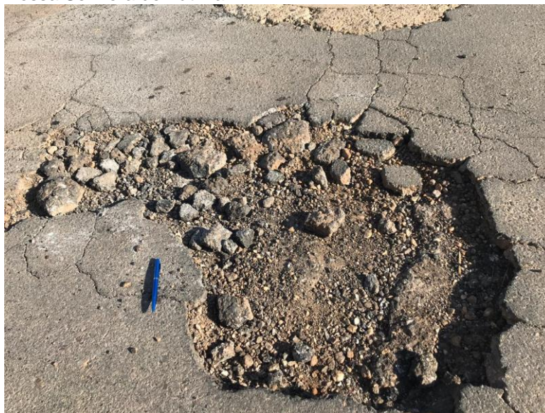
FIGURA 7 – Patologia do tipo “Panela”, encontrada no bairro Nossa Senhora de Fátima.
