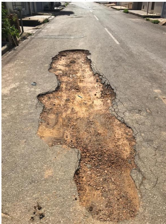
FIGURA 9 – Patologia do tipo “Panela”, encontrada no bairro Vila Mariana.
