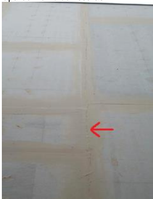
Figura 16 – Realização do tratamento de junta cimentícia com aparecimento de fissuras.
