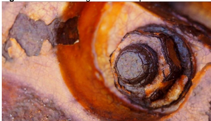
Figura 15 - Corrosão galvânica em parafuso.
