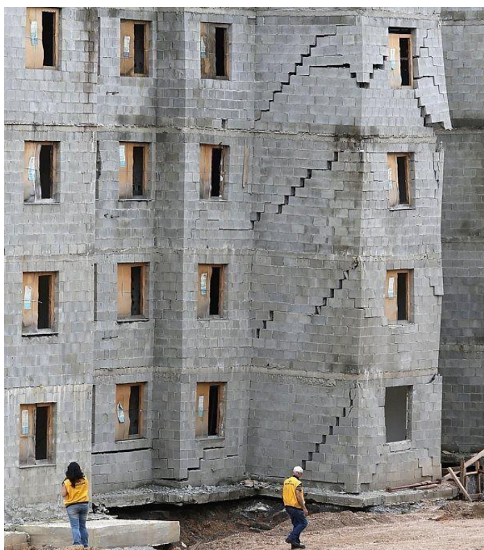
FIGURA 5 – Patologias causadas por recalque diferencial.
