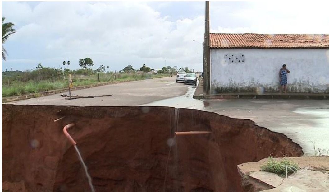
FIGURA 7 – Erosão em estrada em São Luís - MA.
