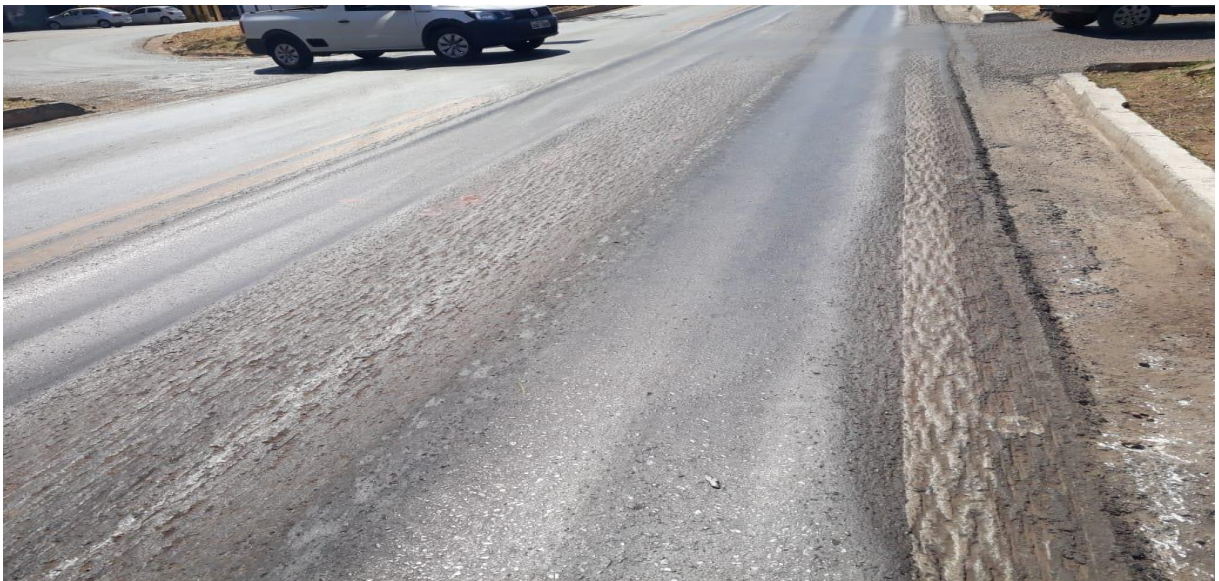
FIGURA 3 - Afundamento plástico longitudinal na trilha de roda
