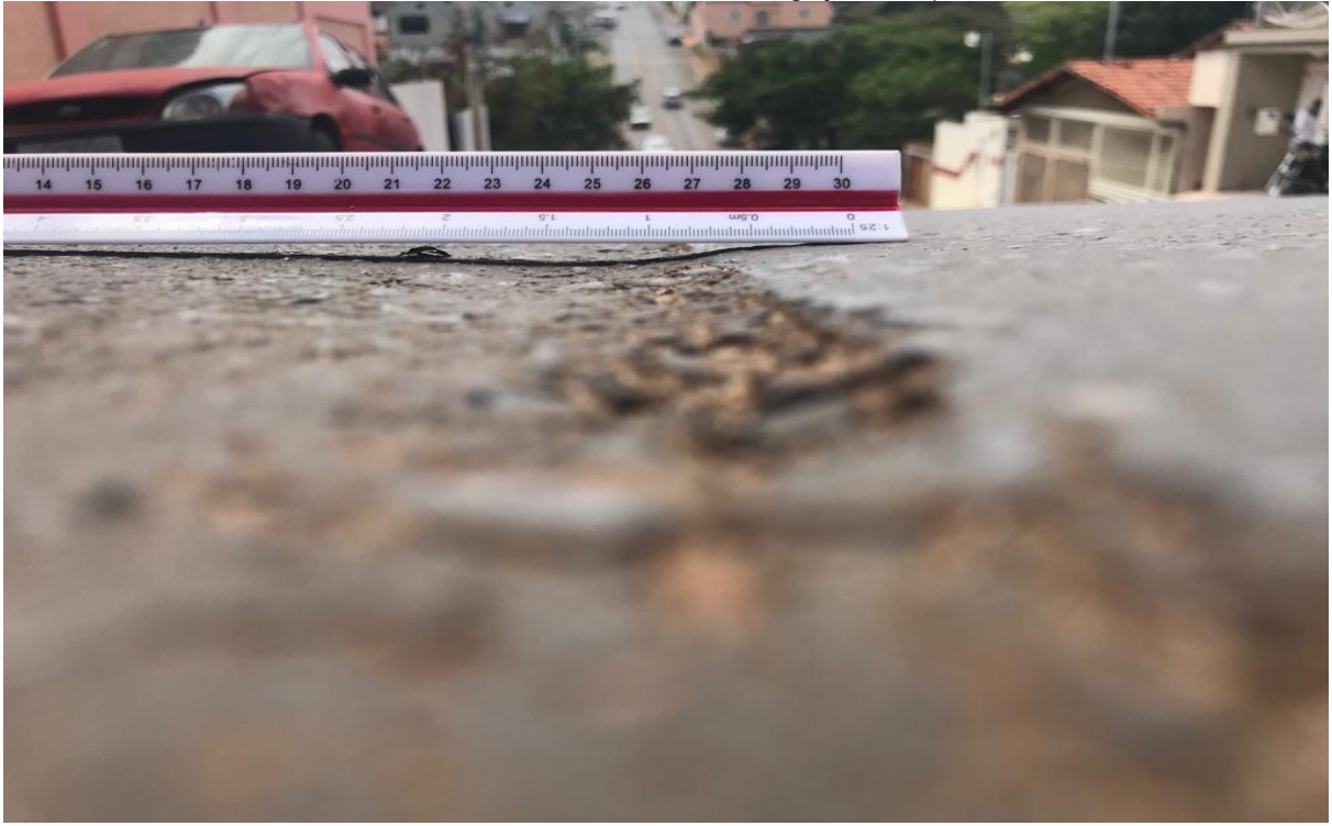
FIGURA 25 - Afundamento na borda de ligação dos pavimentos
