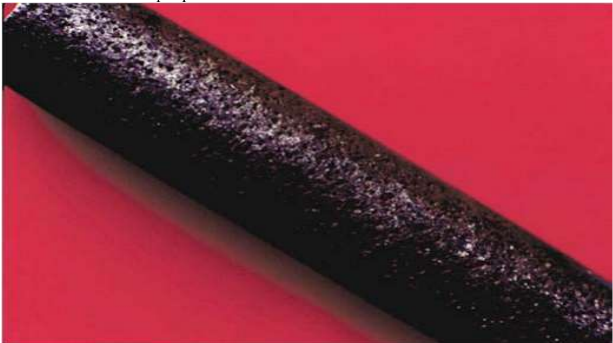
FIGURA 4 – Corrosão por pites.
