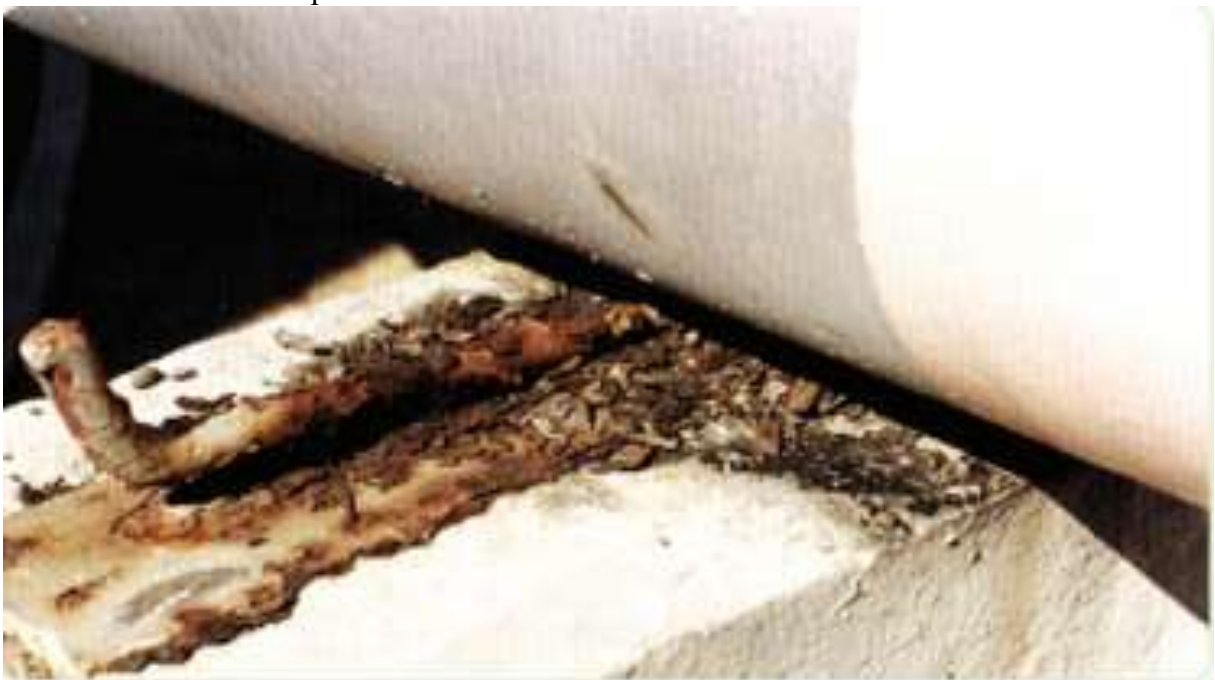
FIGURA 3 – Corrosão por frestas.
