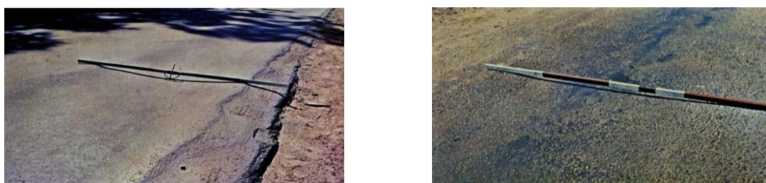
Figura 5 – Afundamento de trilho de roda e afundamento local.
