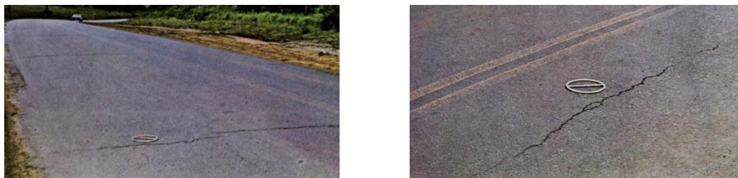
Figura 3 – Trinça isolada transversal e longitudinal.
