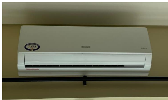
Ar condicionado - lab. Habilidades
